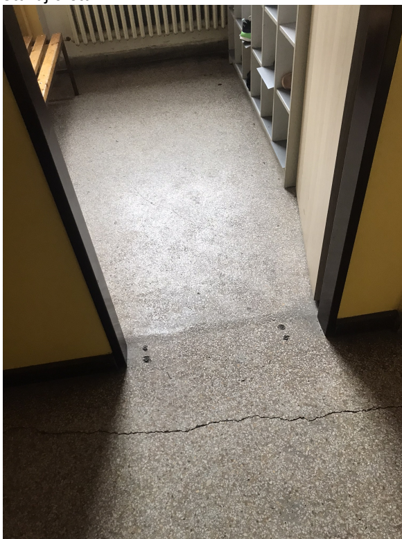
Stávající teraco s prasklinou a otvory po původních konstrukcích
